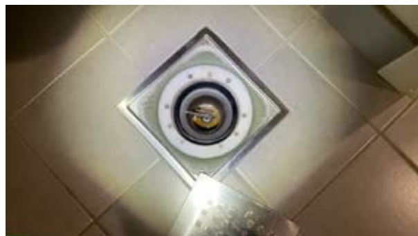
Sluk på vaskerom
