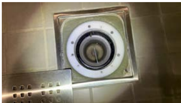
Sluk på bad
