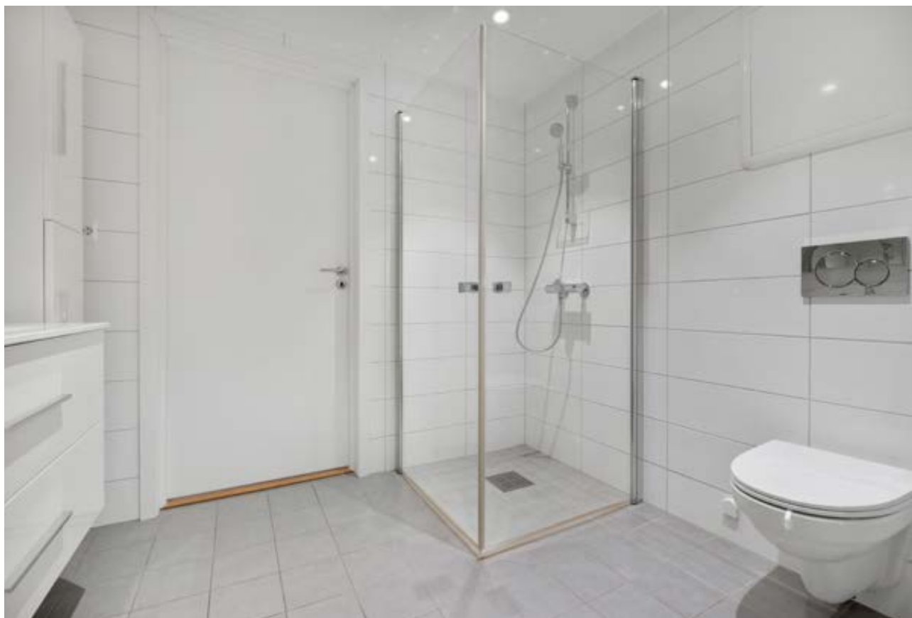
Det er montert spotter i tak.
