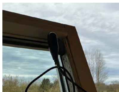
Fukt/råteskade på list som holder glass
