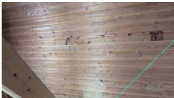
Fuktskjoler innvendig i taket.
