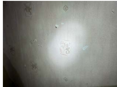
Skade på tapet på vegg.
