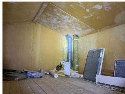
Kloakk er luftet over tak.
