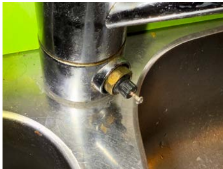
Defekt/falt av krandel for vann til oppvaskmaskin
