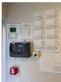
Felles brannvarslingsanlegg i bygget
