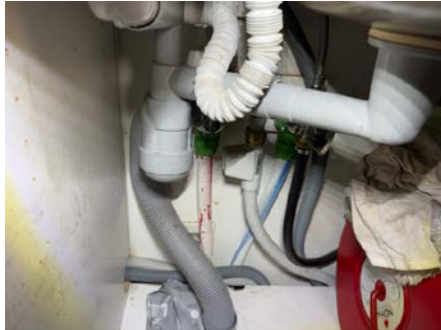
Rørøpplagg i kjøkkenbenk
