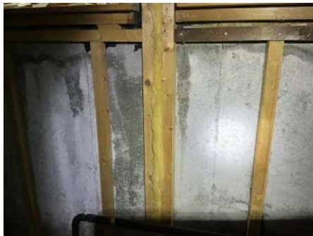
Synlige fukt-merker på grunnmur.
