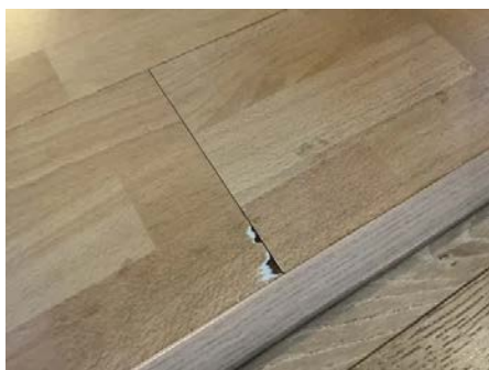
Skade på laminat på kjøkken.
