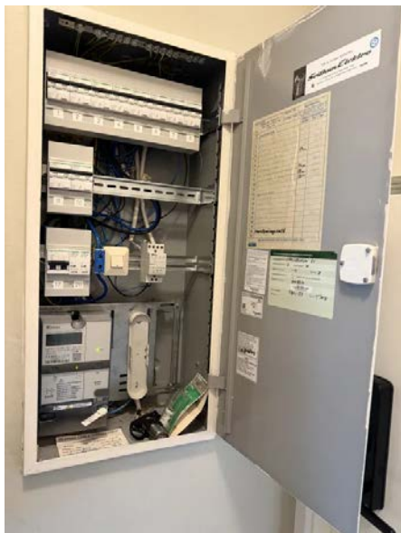
Sikringsskap står i entre 1 etasje.
