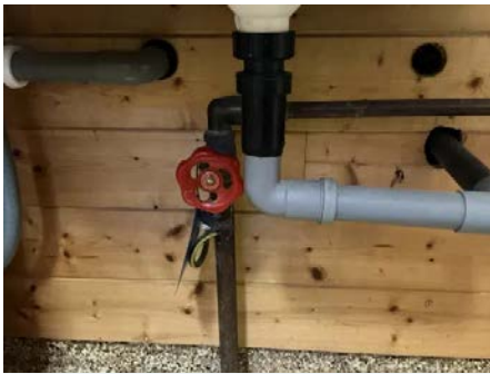
Hovedstoppekran i vaskerom.
