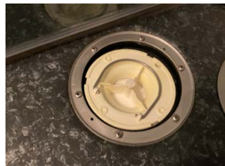
Sluk, synlig membran klemt under klemringen.
