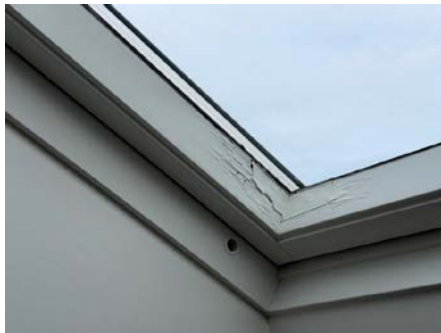
Eksempel på skade i vinduskarm.
