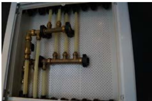
Innfelt fordelerskap 2. etasje
