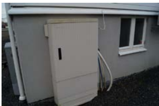
Tilknytningsskap utenfor bolig
