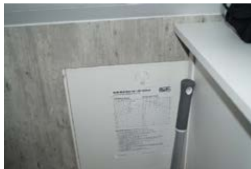
Innfelt fordelerskap på loft
