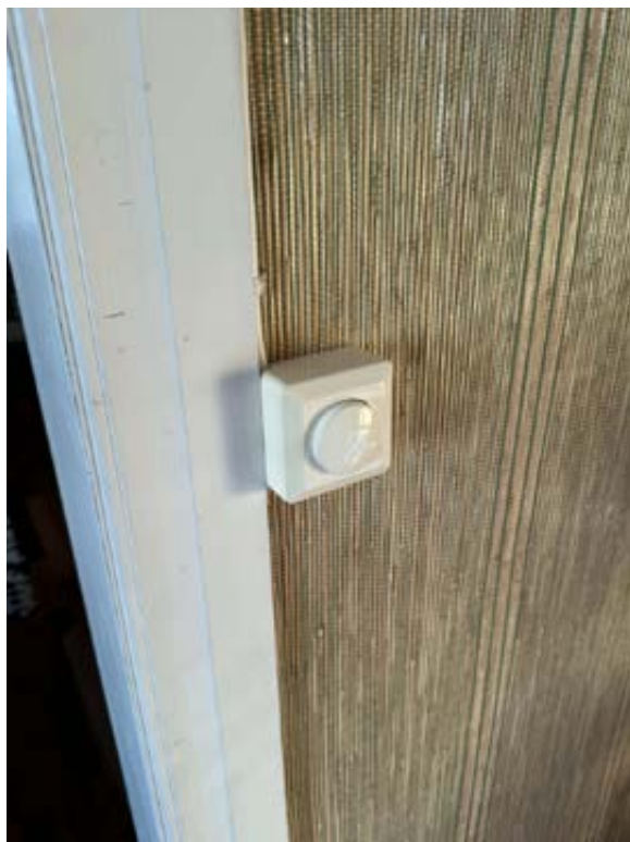
Skjema: "NELFO Per. kontr. Bolig S1" Spørsmål: Neste periodiske kontroll Beskrivelse: Bilder avvik 7, Filnavn: Defekt dimmer stue.jpg
