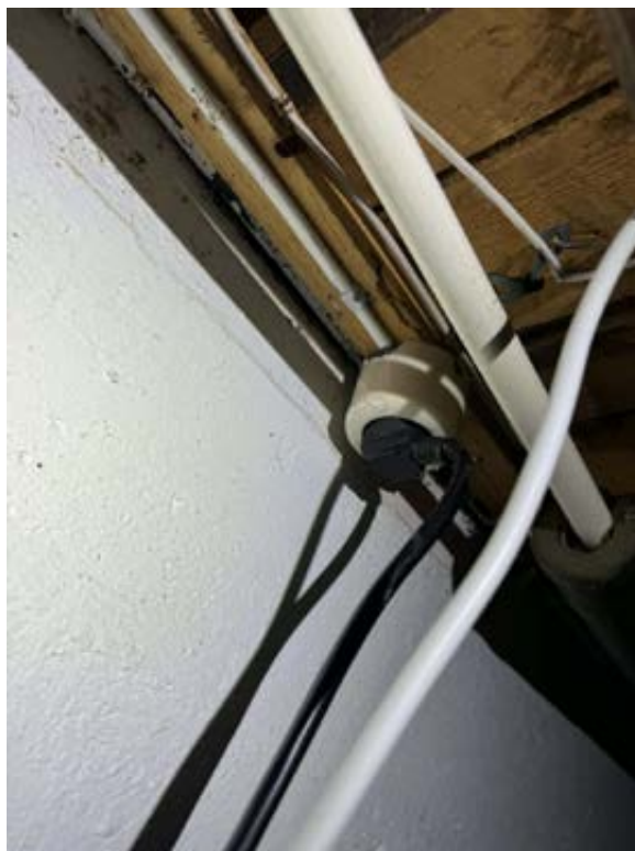
Skjema: "NELFO Per. kontr. Bolig S1" Spørsmål: Neste periodiske kontroll Beskrivelse: Bilder avvik 8, Filnavn: Defekt stikk.jpg
