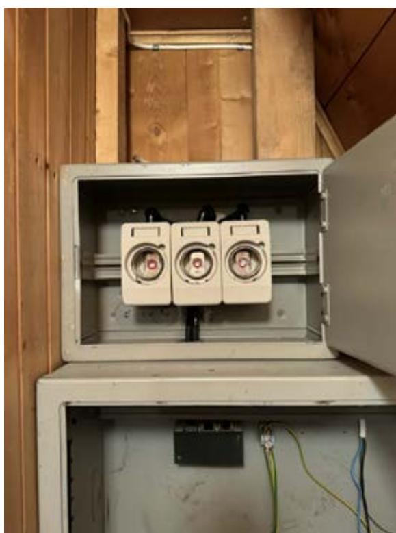
Skjema: "NELFO Per. kontr. Bolig S1" Spørsmål: Neste periodiske kontroll Beskrivelse: Bilder avvik 3, Filnavn: Spenning på gammelt inntak.jpg
