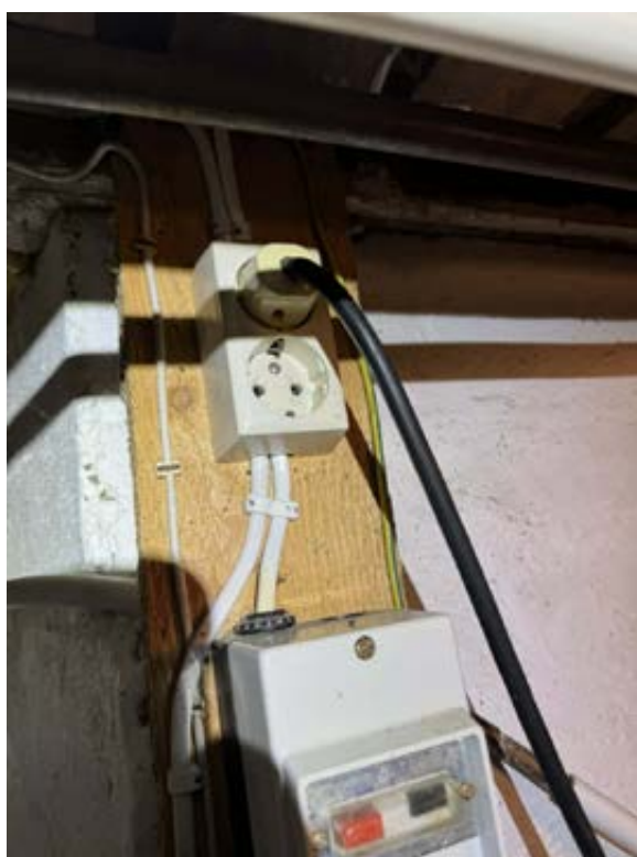
Skjema: "NELFO Per. kontr. Bolig S1" Spørsmål: Neste periodiske kontroll Beskrivelse: Bilder avvik 9, Filnavn: Fast installasjon ved vanninntak for strøm til sirkpumpe.jpg
