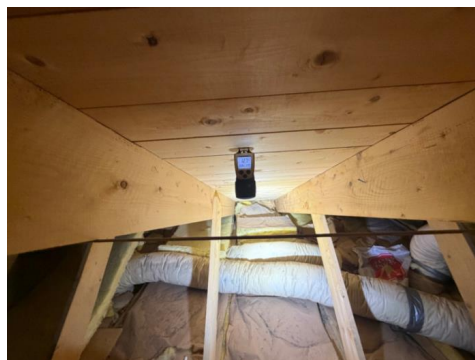
Fuktmåling i undertak, ikke utslag på fukt.
