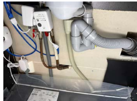
Røropplegg i kjøkkenbenk
