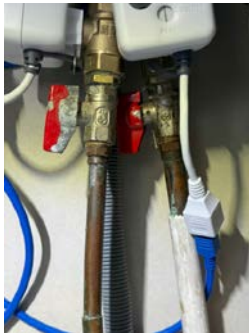
Stoppekraner i kjøkkenbenk samt vannsikring
