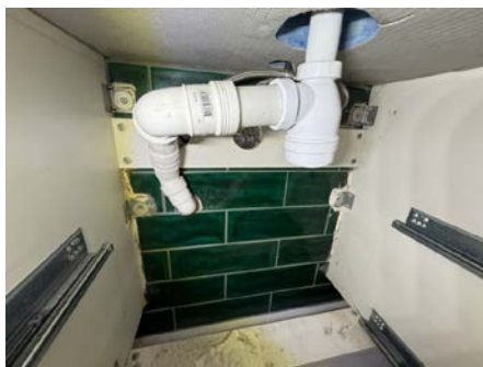
Røropplegg i servantskap
