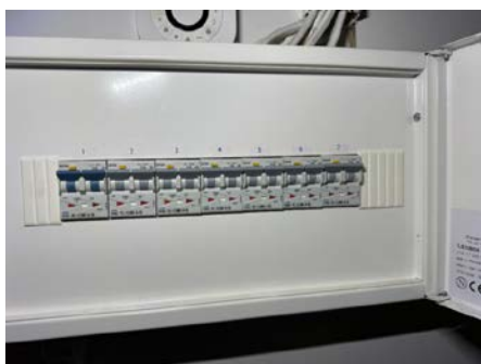
Elskap, plassert i entre.
