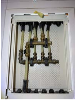
Rørskap i baderomsvegg med 2 x stoppekraner
