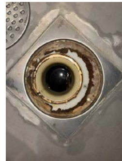
Eldre sluk. Misfarging på mikrosementen rundt slukristen.
