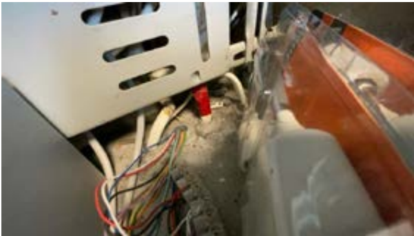
Visuell skade på kabel.
