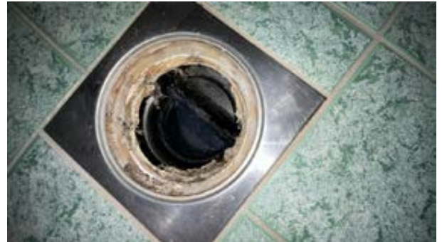
Plastsluk med slukforlenger.
