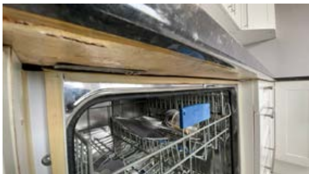
Svellskader i benkeplate over oppvaskmaskin
