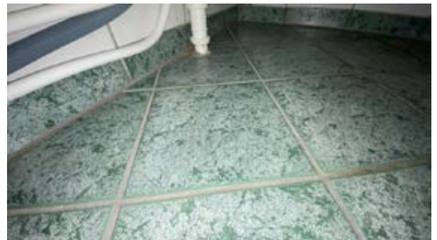
Ikke synlig bruk av rørmansjetter .
