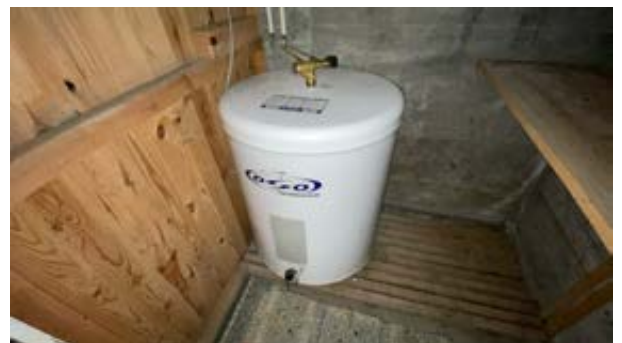
Varmtvannsbereder i kjellerbod.
