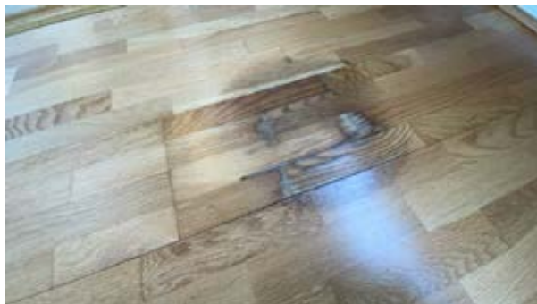
Skade på parkett i stue.
