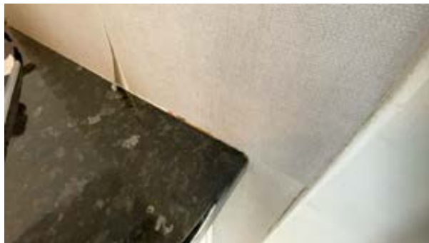
Løs tapetskjøt på kjøkken.
