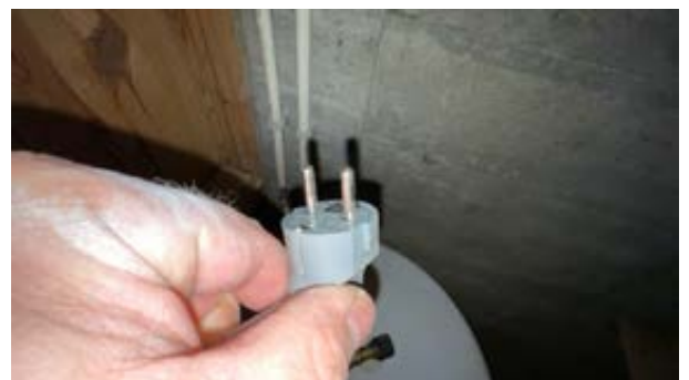
Ingen svimerker på stikk ved dagens befaring.
