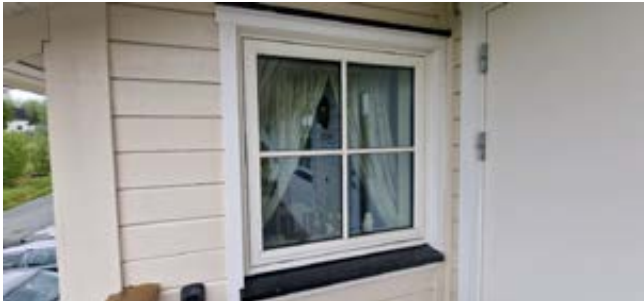
Vinduer med 2 - lags energiglass.
