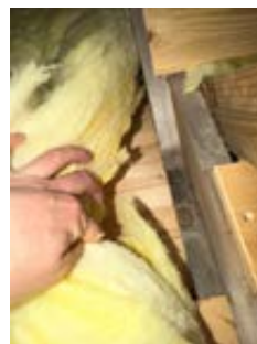
Manglende dampsperre i etasjeskille.
