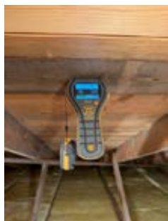
Fuktmåling i taktro. Måleresultat: 11,6 vekt%. Tørrt treverk.
