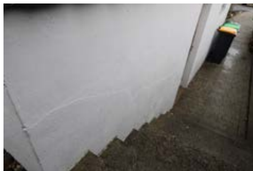
Stedvis noe utidsmessig overflate på utvendig malt grunnmur.
