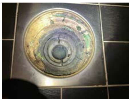
Sluk bad i underetasje
