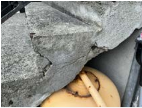
Riss/sprekker på utvendig trapp.
