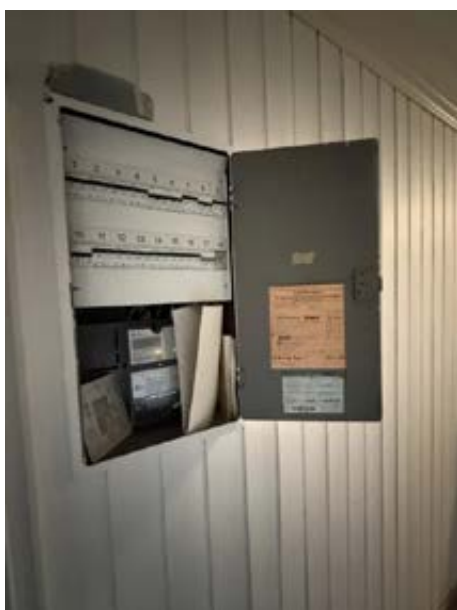
Sikringsskap står i gang 1 etasje.
