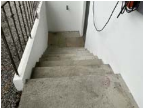
Hånd-rekke på tapp til kjeller er ikke montert.
