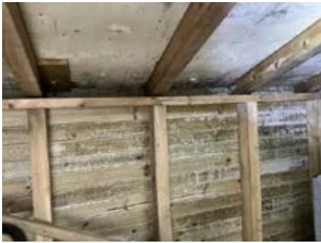
Fukt.-merker i tak på utvendig bod.
