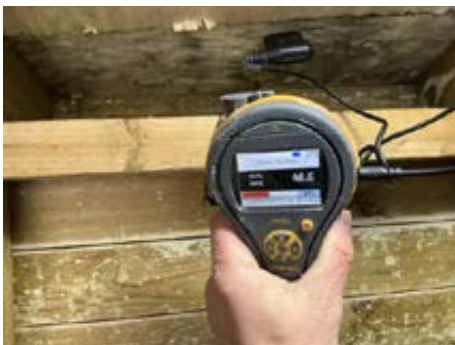
ved fukt-søk er det registrert forhøyede verdier.
