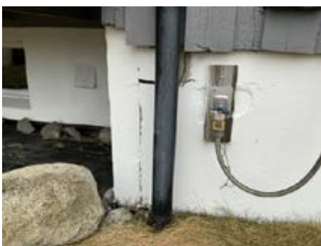
Sprekk i mur mellom garasje og bolig.
