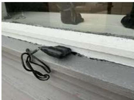
Fukt/råteskade på stuevindu.
