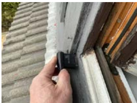
Fukt/råteskade på vindu i ark.
