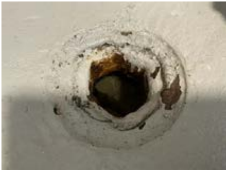
Sluk med støpejern i vaskerom.
