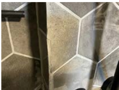
Riss/sprekke i fuger ved dusj.
