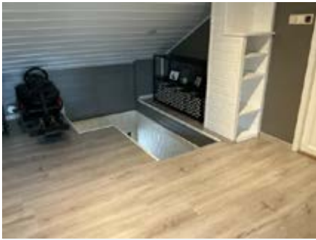
Rekkverk på trapp til loft er ikke etablert.
