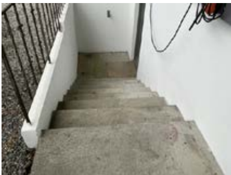
Hånd-rekke på trapp til kjeller er ikke etablert. det anbefales å montere hånd-rekke etter gjeldene krav.
