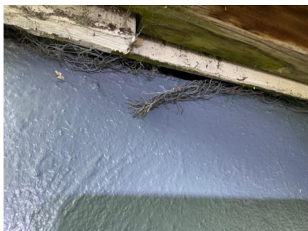
Hønsenetting er løsnet.
