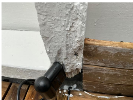
Fukt/råteskade på rekkverk.
