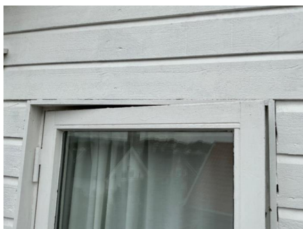
Vannbord er ikke montert over dør.
