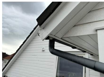
Fukt/råteskade på vindski.
