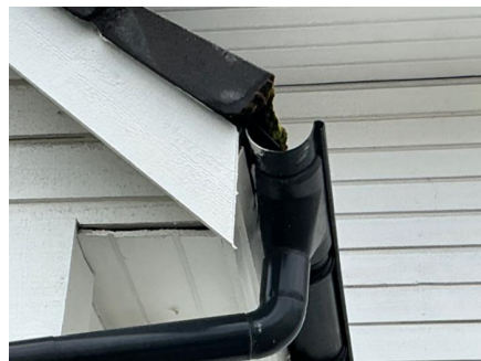
Ende-stykke mangler på takrenne ved inngang.
