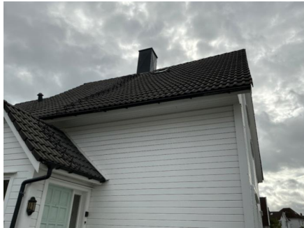
Synlig skjevhet/sig i takkonstruksjon observert fra bakke.
