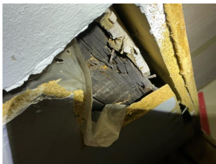
Kun liten del av opprinnelig takkonstruksjon er synlig. Borebille/morr er observert.
