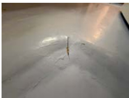
Brudd i membran i dusjsone.
