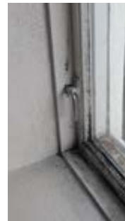
Gammelt vindi på soverom i hovedetasje
