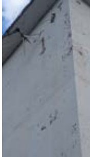
Utvendige riss, sprekker og avskalling av puss.
