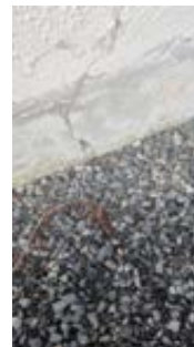
Utvendige riss, sprekker og avskalling av puss.
