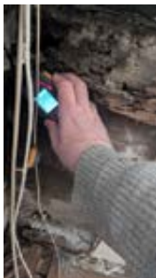
Fukt på innside av veggkonstruksjon på stue i hovedetasje.
