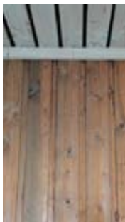
Tydelige fuktmerker i himling over trappeløp.
