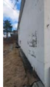
Utvendige riss, sprekker og avskalling av puss.
