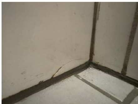
Sprekk i flis ved servanten.
