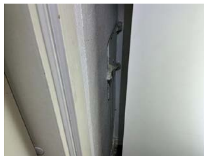
Liten avstand mellom feie-luke og klesskap.
