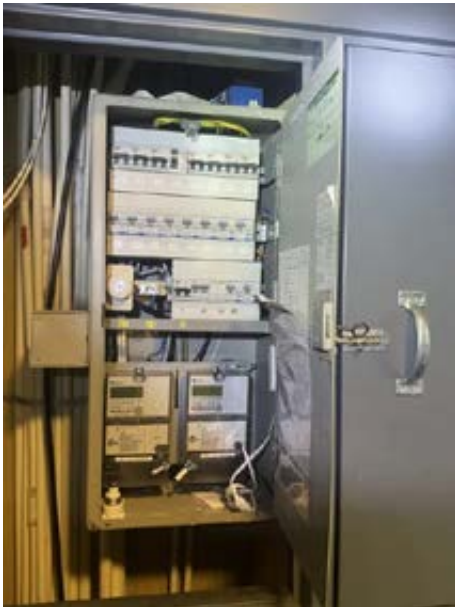
Sikringsskap står i felle svalgang (utvendig).
