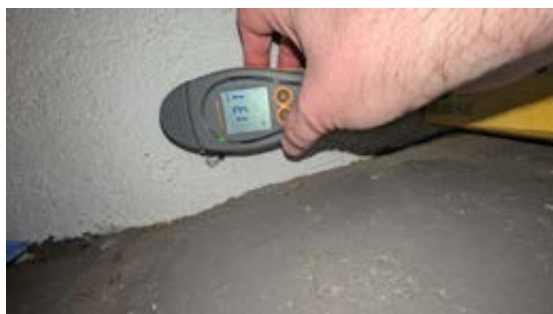
Fuktmåling på vegg i boden. (tørt)
