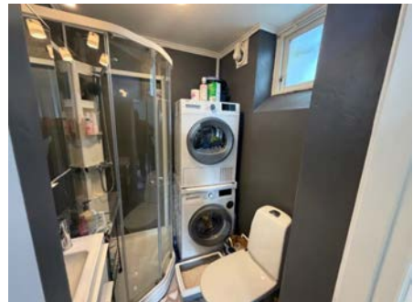
Oversiktsbilde av badet. Manglende membran/tettesjikt på vegger utgjør TG3 avvik selv om det dusjes i tett dusjkabinett.
