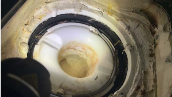
Sluk bad 2.etasje
