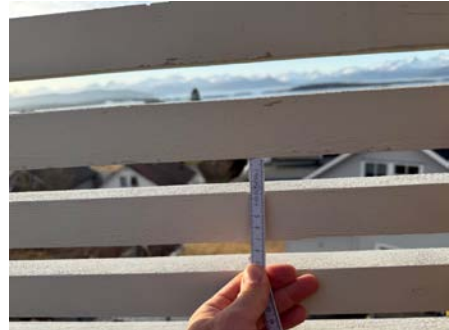
Åpninger mellom liggende trespiler er over 20 mm.
