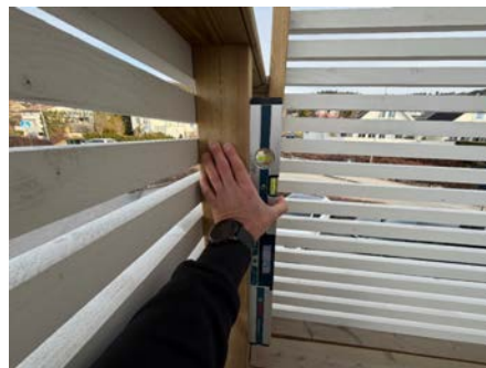
Rekkverk er 24 mm per meter ute av lodd i hjørne mot nordvest.
