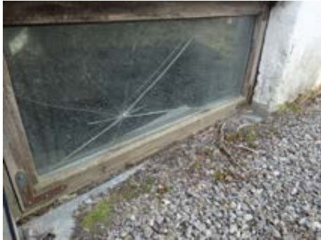
Kjellervindu med knust glass
