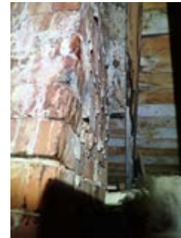
Fuktmerker i taktrao og sperre ved pipegjennomføring.
