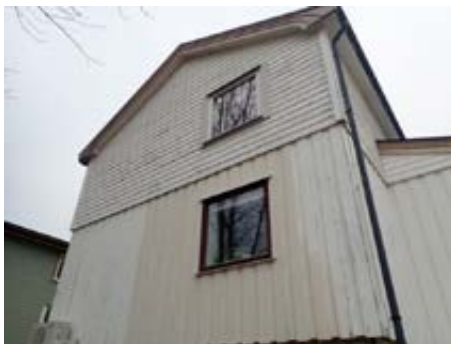
Værslitt kledning. Bør overflatebehandles.
