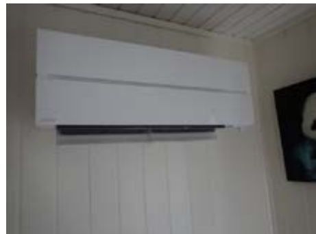
Varmepumpe luft til luft
