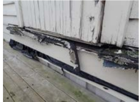
Vegg under altandøra må fornyes. Fare for råteskader er påregnelig
