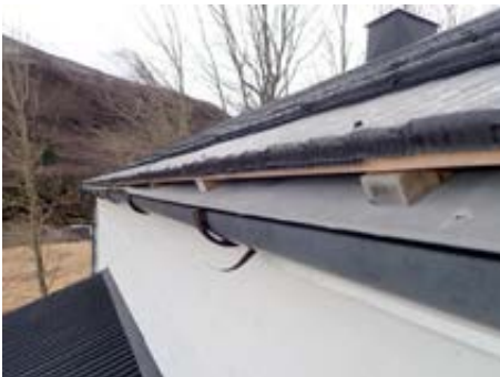
Mangler spillblikk Rustet takrennekroker.
