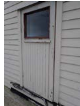
Trekkfull og råteskadet altandør må byttes.
