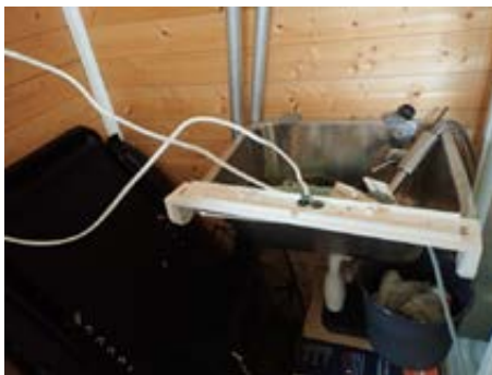
Løs taklys armatur med ledninger på vaskerom.
