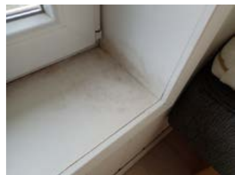
Fuktskader i foring
