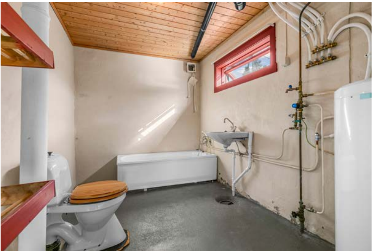
Bad / Vaskerom i underetasjen
