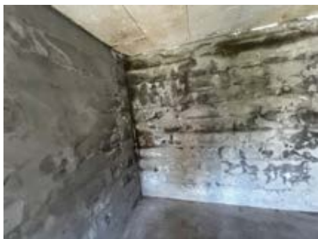
Mye avlering av salt/kalkutslag på grunnmurer i integrert garasje.
