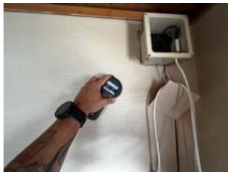
Normale verdier over bakkenivå. Referansemåling. Utslag på fukt på vegg ned mot gulv, ikke utslag på fukt i øvre del av vegg. Forsterker teorien om kapillært oppsug fra grunn.
