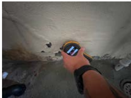
Utslag på fukt ved fuktsøk på overflater ned mot gulv i badet i kjeller/undertasje.
