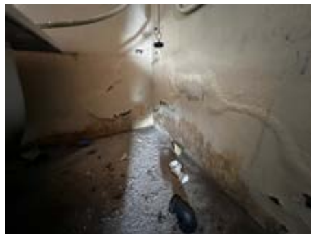
Mye avflassing grunnet fuktinnsig.
