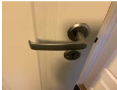
Slitasjegrad ved skilt/vridere
