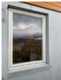
Kjellervindu uten beslag under og avvik på fuger
