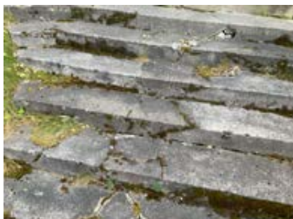
Sprekker i betongkonstruksjoner
