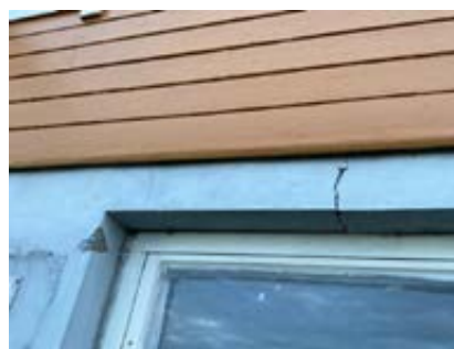
Oppsprekking over vindu
