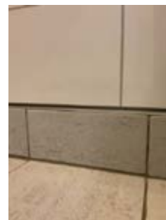
Ikke fuga mellom plate og bunnprofil.
