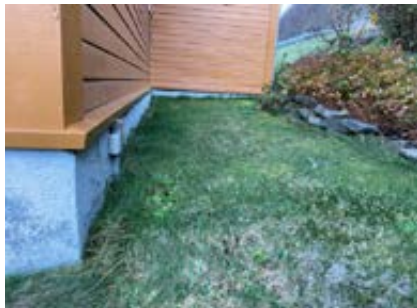
Terrenget faller mot bolig
