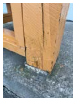
Fukt/råteskade nedre del søyle
