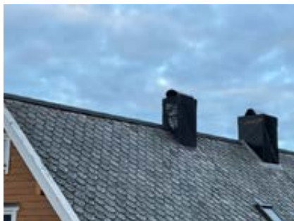
Avflassa overflatebehandling, korrosjon(pipebeslag)
