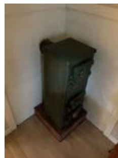
Uten plate på gulv foran ildsted
