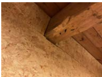
Bjelke i etasjeskille med skader etter borebille/mott
