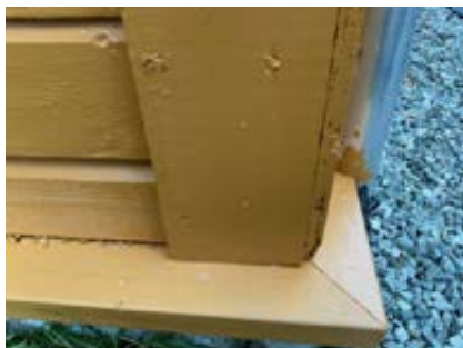
Råte i hjørnebord tilbygg øst
