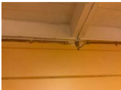
Overflateavvik etter endra el.opplegg
