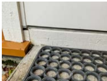
Ikke beslag under dør mot nord
