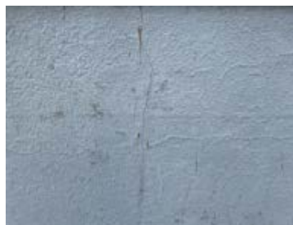
Riss/mindre sprekk sørside
