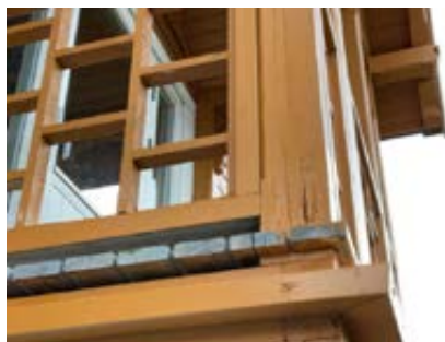
Fukt/råteskade nedre del søyle
