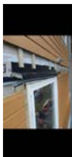
03.07.25: Bilde etter utbedring, overkantbeslag med oppkant begge sider, ført inn bak kledning.
