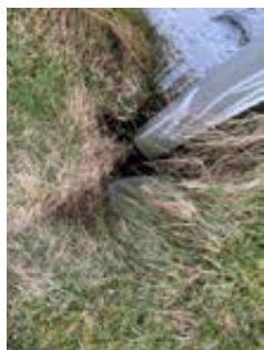
Manglende bortledning fra bygningen
