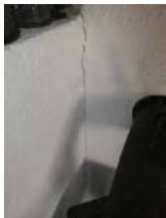
Sprekk mellom pipe og brannmur
