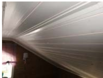
Noe innvendig skjevheter i konstruksjonen, men ikke av betydning.
