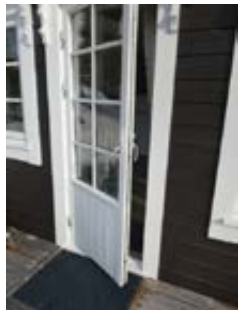
Terrassedør. Dørblad har litt værslitasje
