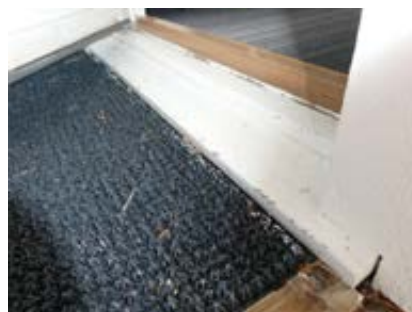
Metallbeslag under terskel er ikke etablert
