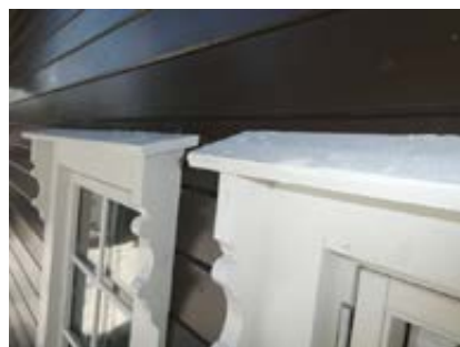
Beslag over vinduer er ikke etablert.
