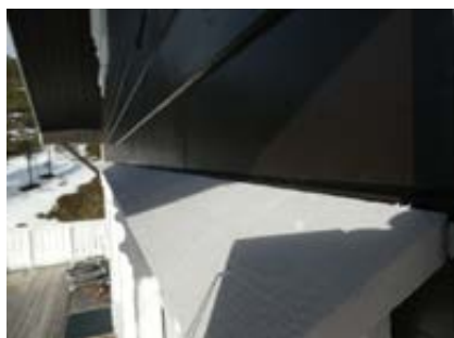
Metallbeslag over dør er ikke etablert
