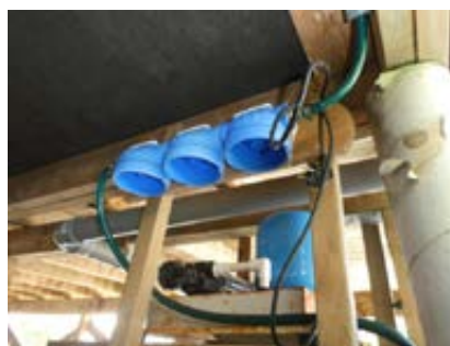
Div. utstyr til vannanlegg
