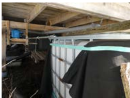
Vanntank for lagring av regnvann fra taknedløp
