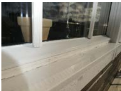
Noe værslitasje på karm
