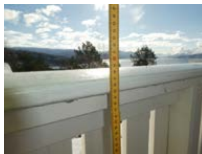
Rekkverk under 90 cm. Dagens krav er 100 cm.
