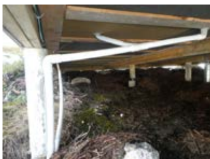
Avløp under bad. Ikke fagmessig utført.
