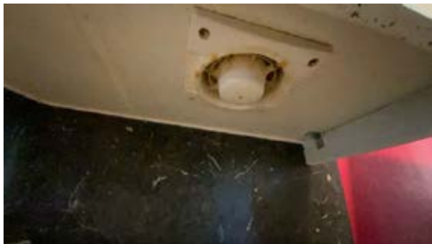
Avtrekksvifte uten filter.
