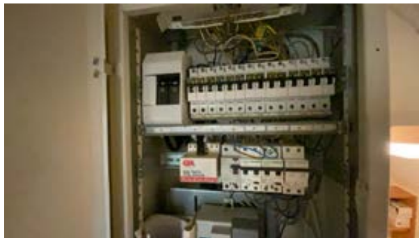
Mangler avdekning på sikringer og jordskinne, medfører berøringsfare
