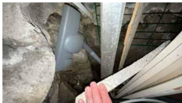
Tegn på fuktvandring gjennom yttervegger.
