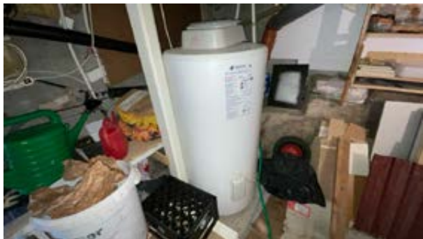
Varmtvannsbereider plassert i kjeller.
