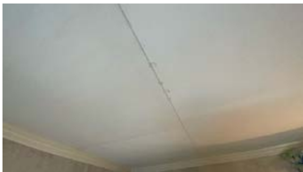
Fuktmerker i tak.
