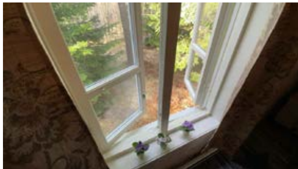
Vindu på soverom vest tilfredstiller ikke krav til åpning ved rømning grunnet midtstolpe.
