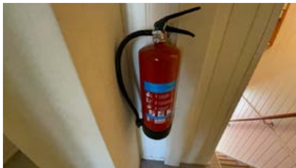
Ikke datomerking på brannslukningsapparater.
