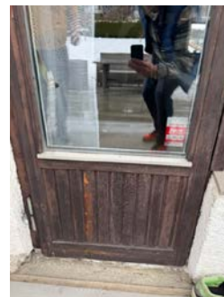
Utvendig værslitt dør og det er sprekker i treverket.
