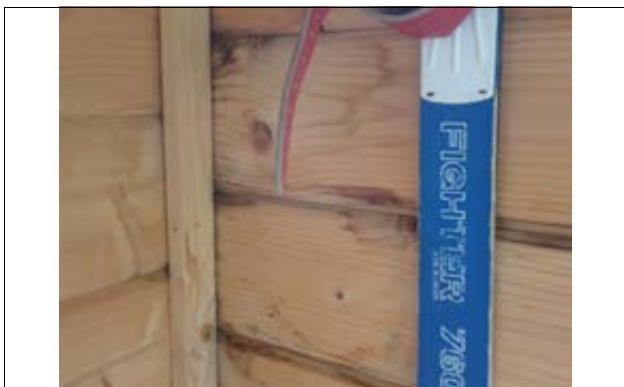
Fuktmerker til veggarealer i grillhuset flere steder
