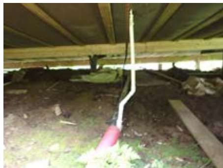
Bilde viser avløpsrør, gråvannsutslipp fra hytta
