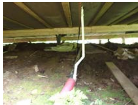
Bilde tatt mot ene avløpsrør for gråvannsutslipp
