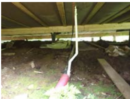
Bilde tatt mot ene avløpsledning ( gråvannsutslipp. Avløp fra WC styres via hyttedo.
