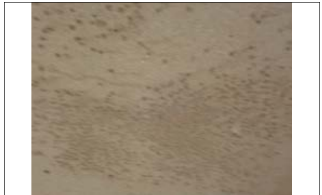
Bilde viser fuktmerker/utslag til bordtak grillhus
