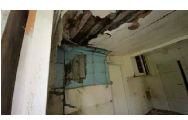
Bilde 6: Bilde tatt gjennom vindu i hovedetasje. Store råteskader/deformasjon i etasje skille mot loft.
