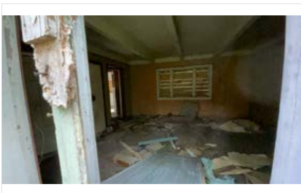
Bilde 8: Bilde tatt gjennom vindu i hovedetasje. Generelt store skader innvendig.
