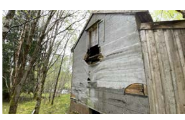
Bilde 2: Råteskader gavlvegg mot vest.
