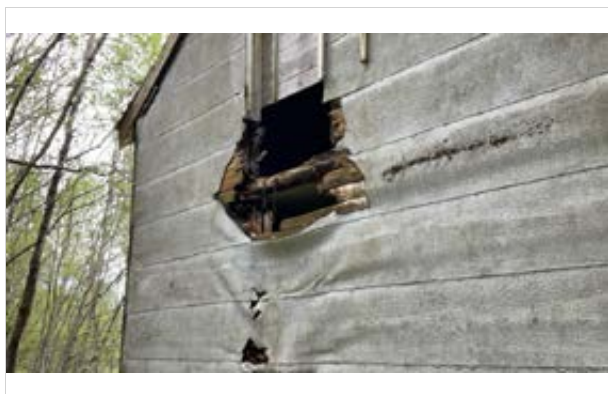
Bilde 3: Råteskader gavlvegg mot vest (som bilde 2)
