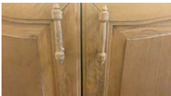
Slitasje på fronter.
