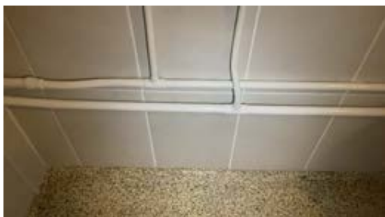
Kobbervannrør fra byggeår.
