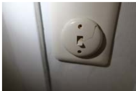
Skadet deksel på lysbryter bad.
