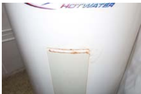
Fuktmerker i front på berederen bør undersøkes nærmere
