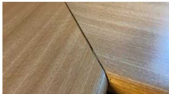
Noe løs folie i skjøt på benkeplaten.
