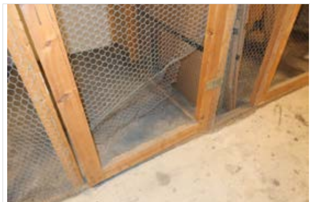
Ødelagt netting på døren.
