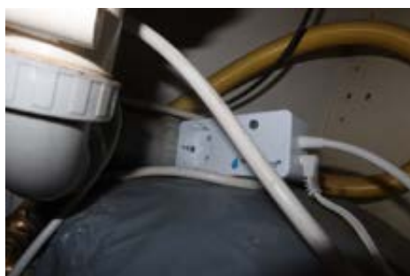
Waterguard i benkeskap kjøkken (ikke tilkoblet på befaringsdagen).
