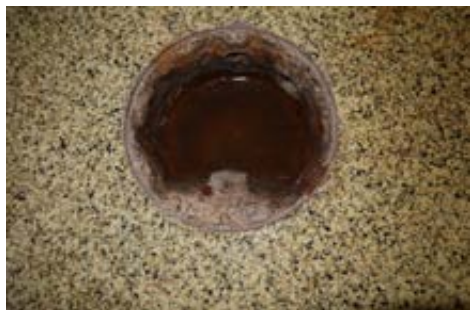
Støpejernssluk fra byggeår.
