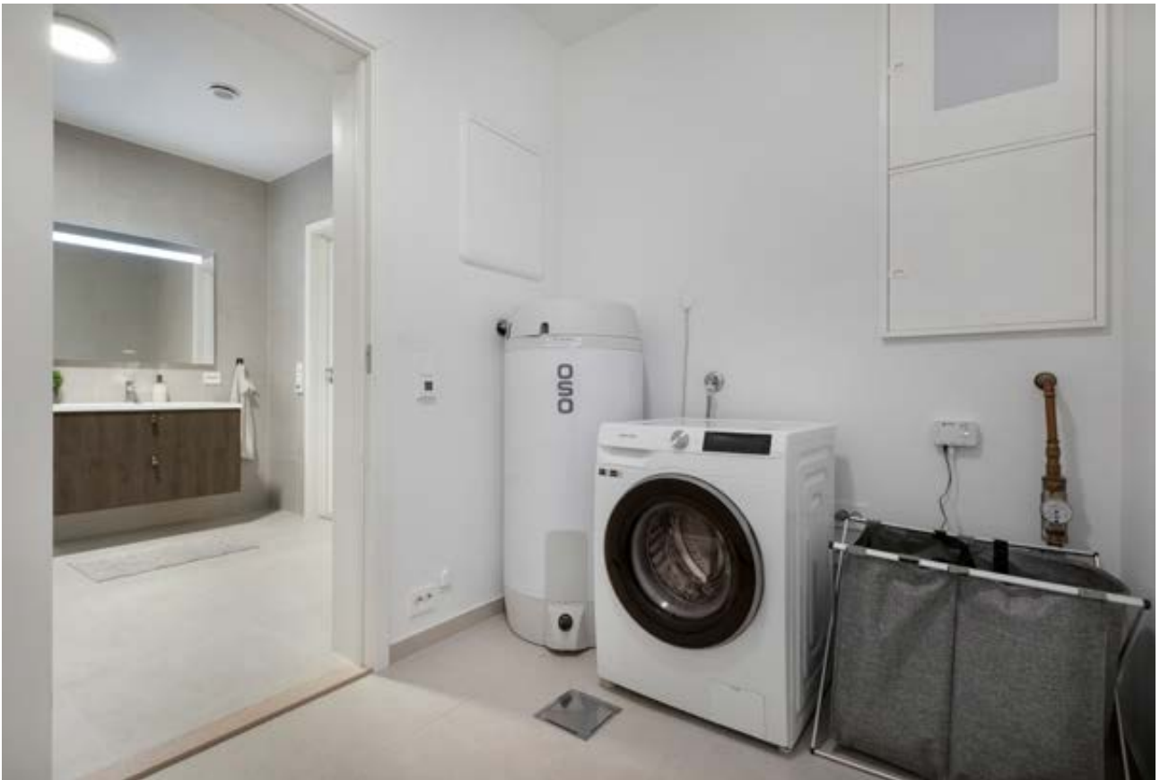
Bod med opplegg for vaskemaskin. Rommet er ikke utført som våtrom
