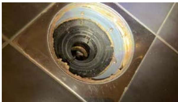
Sluk på bad/vaskerom
