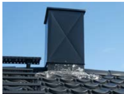
Stigetrinn og Heldekkende beslag over gjennomføring
