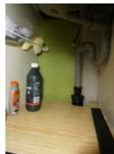
Kontroll i skap. Skapdør er defekt
