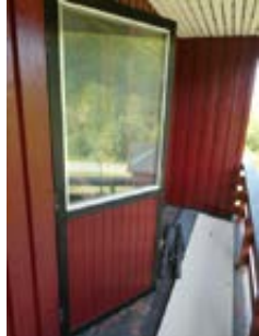
Ytterdør fra soverom er slitt og mangler dørtrykker
