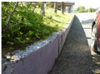
Forstøtningsmur med skjevheter
