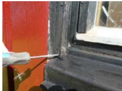
Stedvis slitasje på utvendig karm
