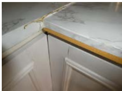
Skade/ slitt benkeplate
