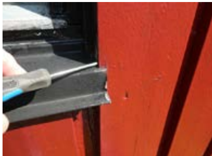
Stedvis slitasje på utvendig karm
