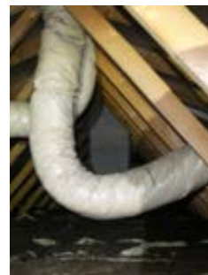
Pipe på kvist ikke nærmere kontrollert pga. vanskelig tilkomst.
