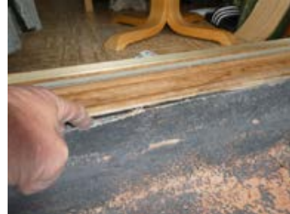
Utskifting/vedlikehold må forventes
