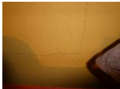
prekk innvendig mur
