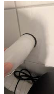
Gjennomføring fra sentralstøvsuger.
