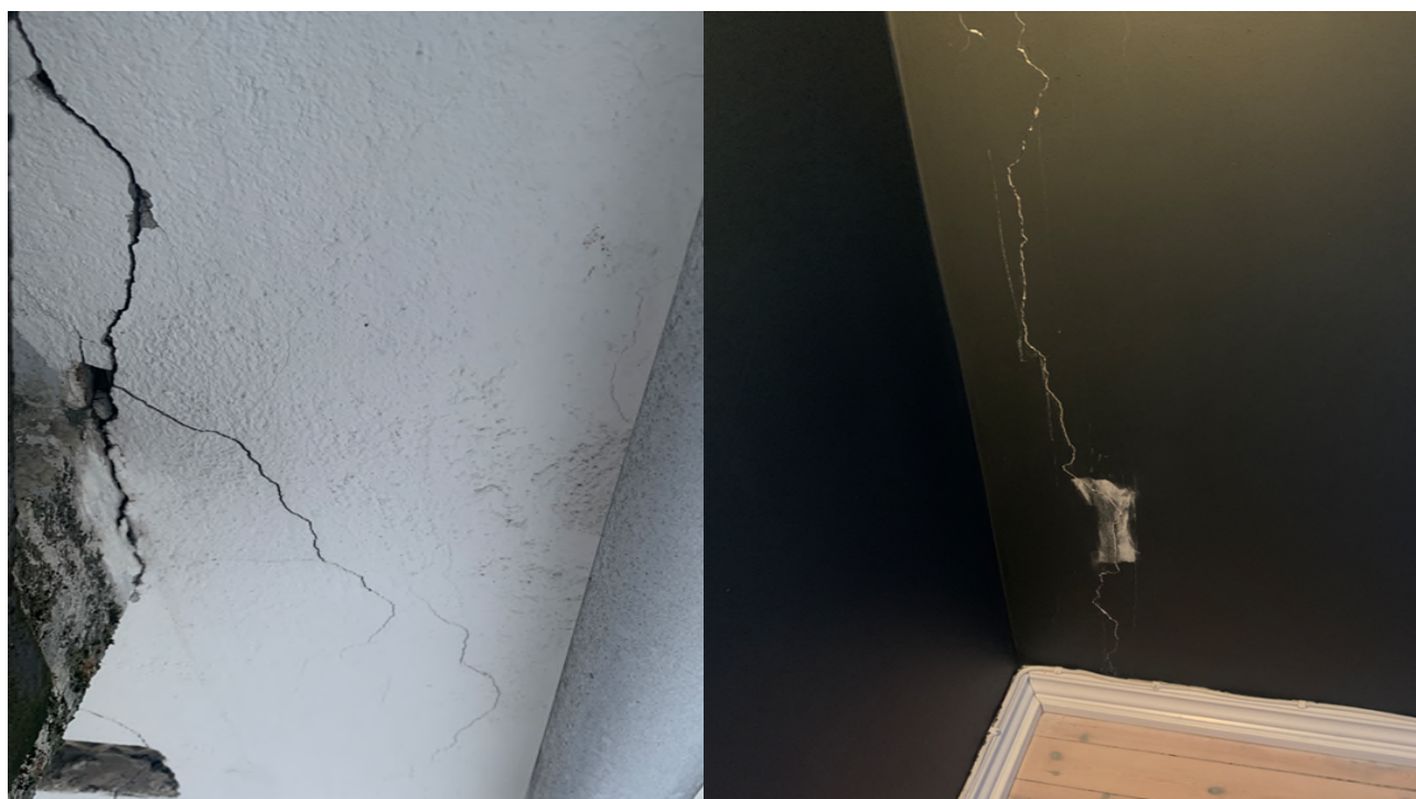
Bilde 3 og 4 Viser gjennomgående riss i yttervegg mot bakgård fra utside og innside..
