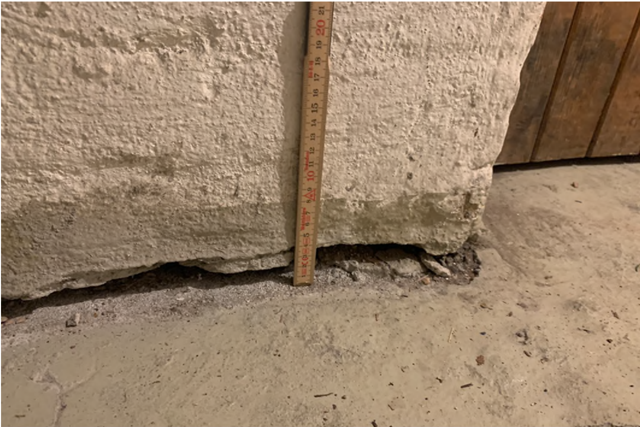
Bilde 9 Viser innervegg i kjeller hvor gulvet har sunket 2-3 cm i Vøyensvingen 1B. Årsak til setninger av gulvet er trolig utvasking av masser. Det er bærende vegger, som yttervegger, innvegger og gavlvegger som er fundamentert på pilarer til fjell. Deler av kjellergulvet hviler på løsmasser og vil følge eventuelle setninger.
