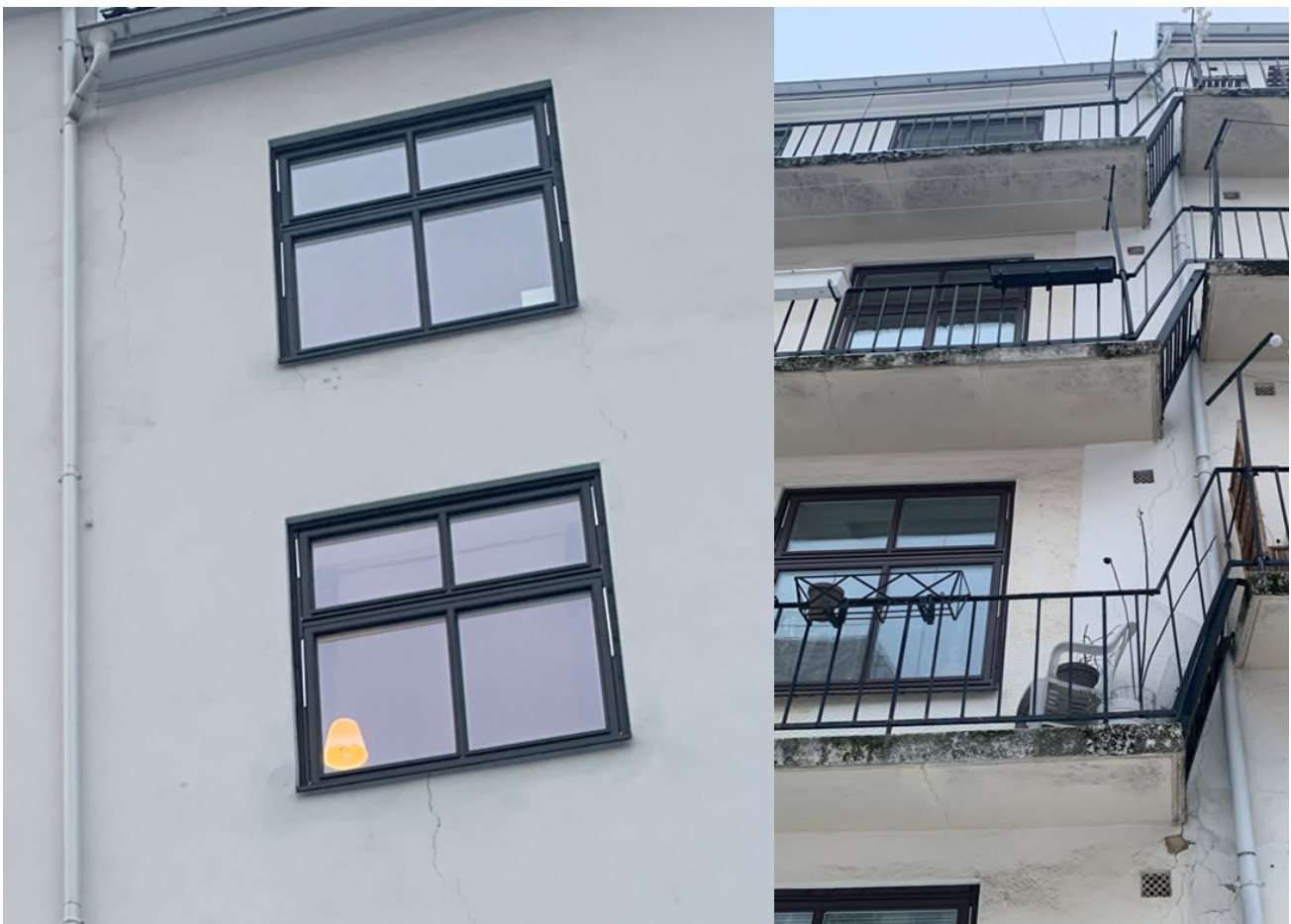
Bilde 7 og 8 Viser gjennomgående riss i yttervegg ved gateside og mot bakgård. Det er også riss i brannbalkonger som kan skyldes spenninger fra bevegelser i bygget. Riss i bakgård følger en mer rett linje ved gavlvegg fra loft til første etasje mot Vøyensvingen 1C. Ved gateside går riss 1,5 meter ned før det stopper og gjenoppstår i underkant av vinduer.
