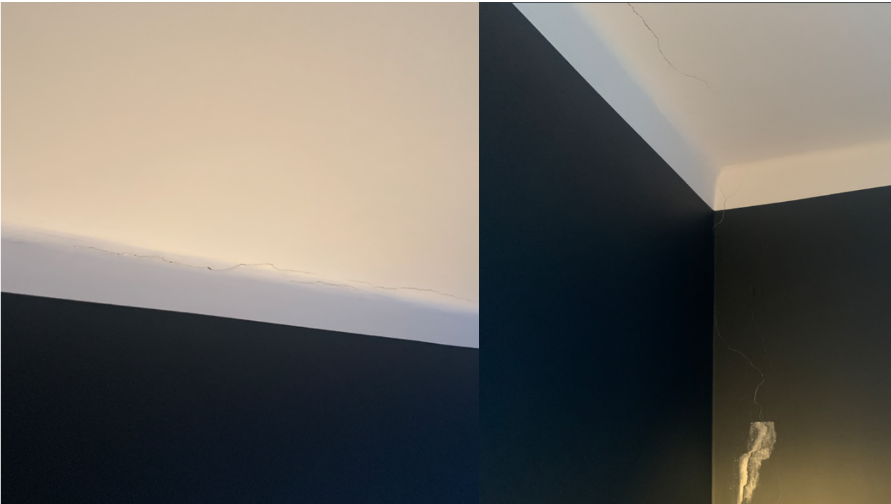
Bilde 5 og 6 Viser gjennomgående riss i yttervegg mot bakgård fra utside og innside. Riss går også langs himling. Det er uklart om etasjeskille mellom 4. etasje og loft er støpt betongdekke eller trebjelkelag med stubbeloftsleire og pusset underside.
