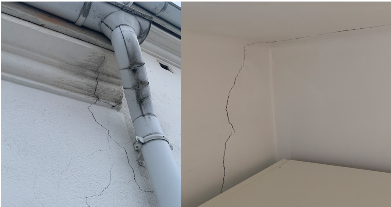
Bilde 1 og 2 Viser gjennomgående riss i yttervegg mot gateside fra utside og innside. Riss går også langs himling. Det er uklart om etasjeskille mellom 4. etasje og loft er støpt betongdekke eller trebjelkelag med stubbeloftsleire og pusset underside.
