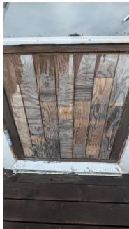
Fuktskader på balkongdør på loft.
