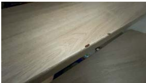
Skade/ hakk i trappetrinn.
