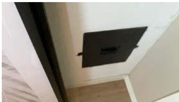
Sotluke er plassert nærme brennbar vegg.
