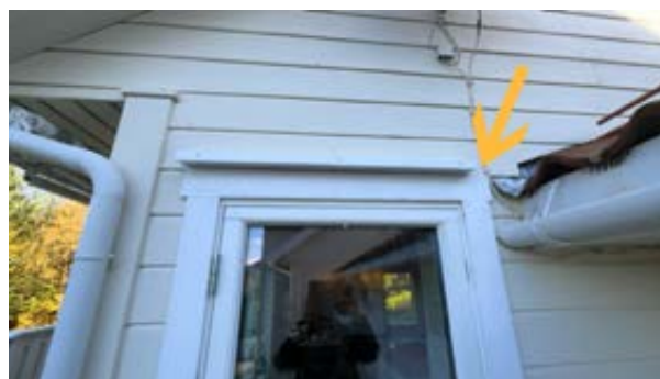
Vannbrett går ikke langt nok ut forbi døren og listverk.
