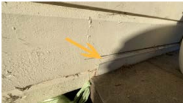
Beslag som har løsnet.
