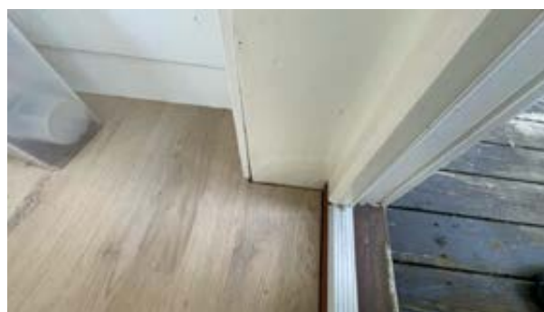
Foring innvendig har posnet opp.
