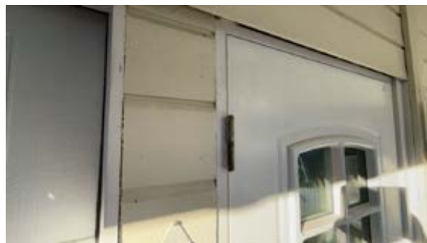
Ytterdøren mangler listverk.
