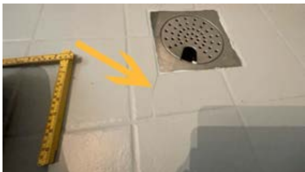
Sprekk i flis. Sprekken er malt over.
