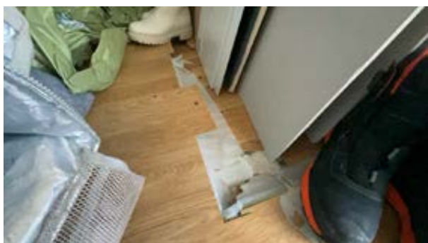
Høydeforskjell i gulvet.
