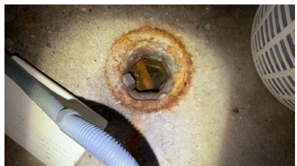
Støpejerns sluk vaskerom
