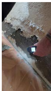
Fuktmåling indikerer høy fuktighet.
