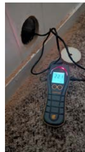
Fuktmåling indikerer høy fuktighet i treverk på kjellerstue.
