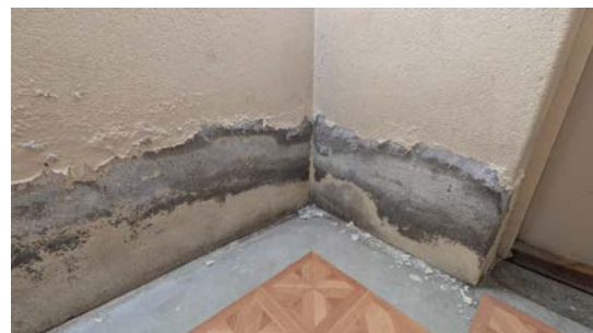
Synlig fuktproblematikk langs vegger.
