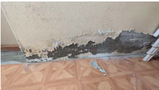
Synlig fuktproblematikk langs vegger.
