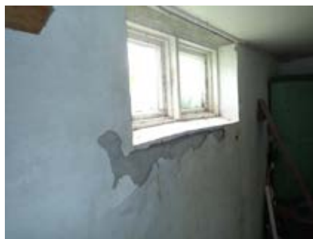
Puss og malingsavskalling.
