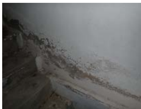
fukt og saltutslag
