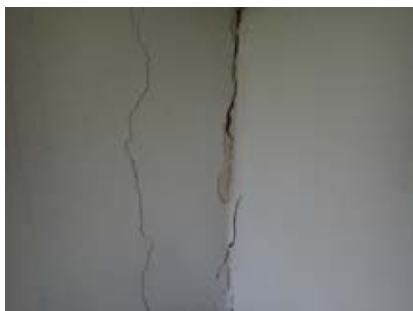
Sprekker i pipen
