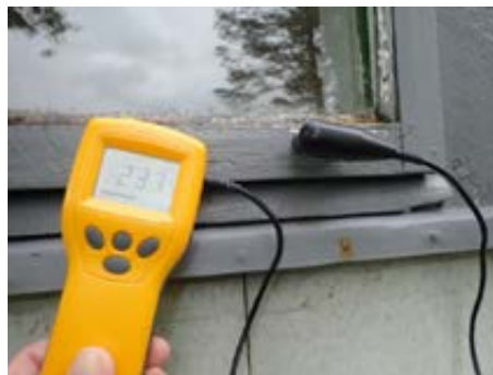
24% fuktighet i glassramme
