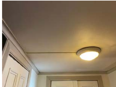
Eksempel fra leilighet seksjon 4. Slik henger alle taklamper i etasjeskillere i leiligheter. Det er ikke hulltatt i gips da strømføring ligger under.
