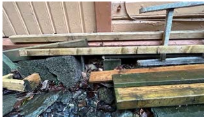
Utette løsninger rundt bygning. Rotteinnganger.
