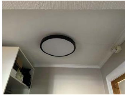
I himlinger er alle lamper montert under med strøm fra vegg.
