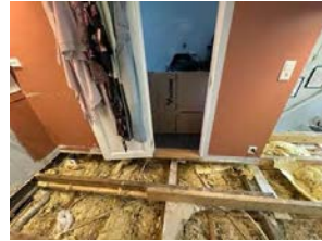
Følgeskader i gulv etter rotteaktivitet strekker seg inn under baderomsgulvet
