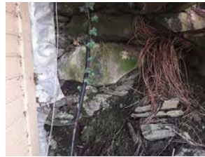
tydelige rottehull inn i sprengsteins mur
