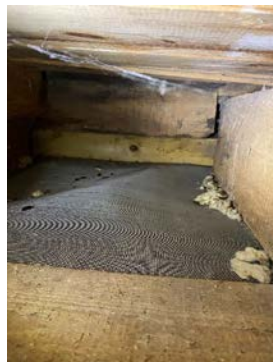
Over murkroner i fellesdel av kjeller er det utført tetttiltak med netting fra tidligere.
