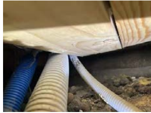
Rotte har gnagd på kabel som går til vv-bereder
