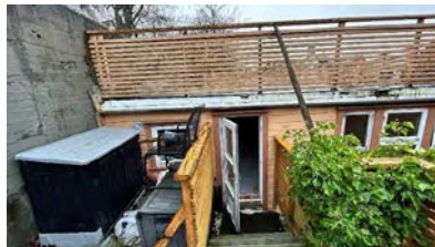
Takterrasse over seksjon 4 er ikke oppbygd som kompakt tak og har heller ikke noe luftesjikt.
