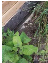
Rottehull i bakken på utsiden
