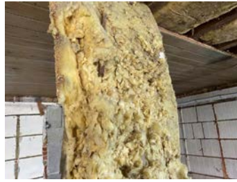
Skader i isolasjon etasjeskiller næringsdel.
