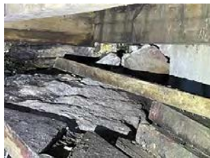
Inn under nevnte plating. Her kan man også se isolasjonsmateriale som rotter muligens har dratt ut
