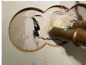
Tettinger fra kjøkken i vegg mot seksjon 3 må sjekkes ytterligere
