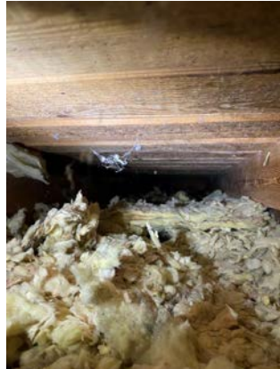
Ganger og skader i isolasjon inn mot boder i kjeller.
