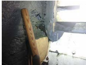
Bak dette beslaget kan rottene komme seg inn i vegg/himling.
