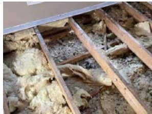
Følgeskader i gulv etter rotteaktivitet.
