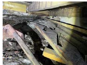
Inn under plating, til venstre for terrassedør.
