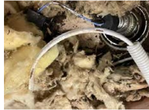
Downlights til boligdelen under. Gnag på kabler.
