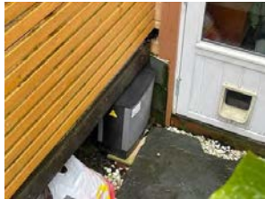
Smart-boks står delvis under plattformen, til venstre for terrassedør.
