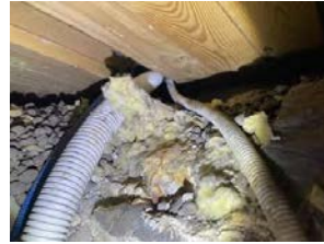
Over grunnmur i sokkeletasjen. Tydelig tegn til rotteaktivitet.
