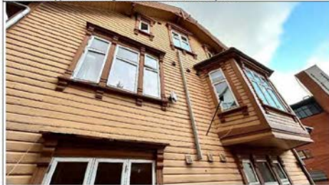
Foto nr. 45 Vindu i karnapp ved brannstige er ikke brannvindu. Må byttes.
