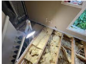
Følgeskader i gulv etter rotteaktivitet.
