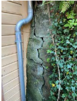
Sprekker i mur ved inngang seksjon 5.
