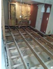
Det er sterk lukt av gnager mot yttervegg
