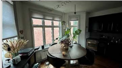
Foto nr. 54 Stue. Vindu i karnaopp må byttes.
