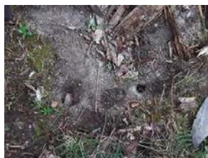
nyere rottehull under grunn.
