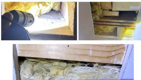
Fullt av rottedrit i bjelkelag både retning terrassedør og under bad.
