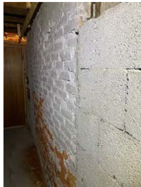
Mur mellom boder og næringslokale må pusses på overflaten
