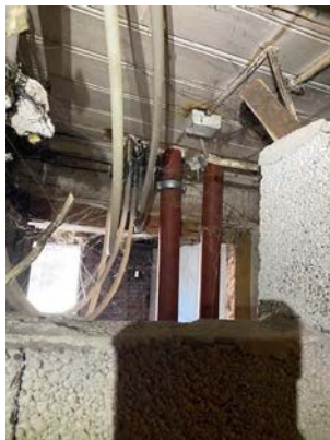
Det er fuget rundt gjennomføringer men må sjekkes ytterligere
