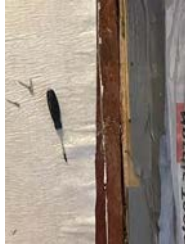
Glippe ved trapp. Tydelig innsig av lukt som følge av rotteaktiviteten som over tid har pågått.
