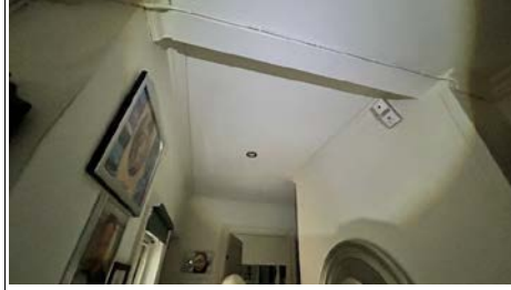
Foto nr. 39 Downlights i himling perforerer brannskillet.
