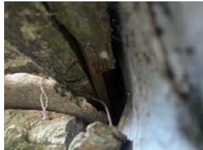
Hull opp under kledningen til høyre for terrassedøren.
