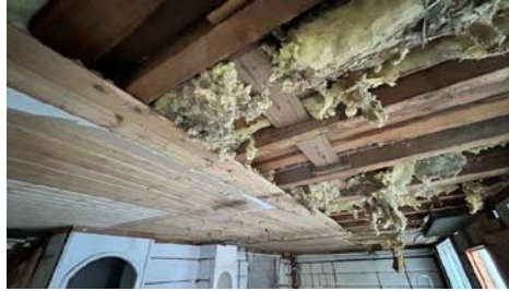
Store mengder rotteavføring i isolert etasjeskille i u.etg.
