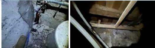
Foto av rom i u.etg. Rottefeller, rottetrit, åpninger i vegger og himling.
