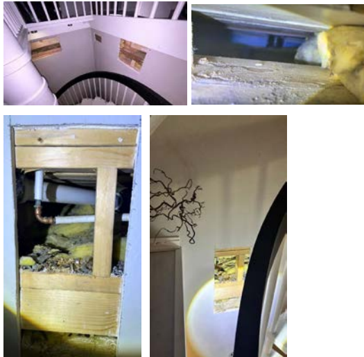
Rottedrit og skade under bad.
