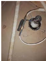
Ledninger som er gnagd på
