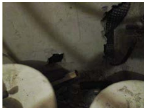
Hull i vegg bak beredere
