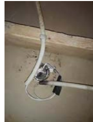
Ledning til spott i 1 etasje
