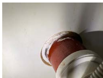
Avløp fra kjøkken er fuget rundt men sjekkes sammen med vannrør.
