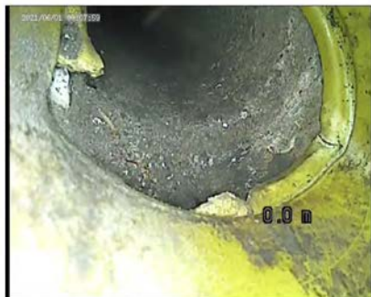
Foto: 1_1_2_23052023_135120_A.jpg 0m, Sprukket rør, sprekkene er åpne/lese teglstein, fra 04 til 08 KI, Tangentløll
