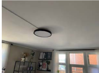
Eksempel fra leilighet seksjon 1. Slik henger alle taklamper i etasjeskillere i leiligheter. Det er ikke hulltatt i gips da strømføring ligger under.
