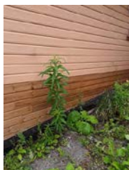
Baksiden vegg der gnaagere har vært bak grunnmur
