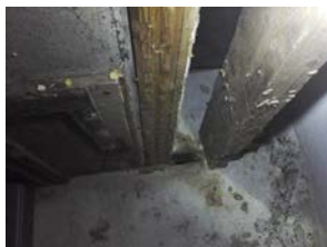
Her i dette lagerrommet er det spor etter rotter opp i hull i betonggulv.
