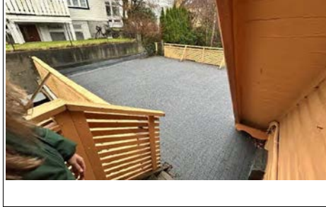
Foto nr. 52 Takterrasse over seksjon 4. Er ikke E160. Tak feil konstruert.
