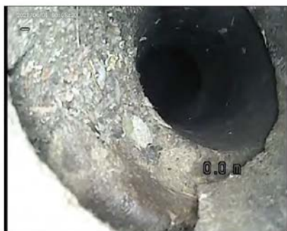
Foto: 1_1_3_23052023_135409_B.jpg 0,2m, Sprukket rør, Rørbiter har løsnet eller mangler/teglstein mangler fra sin opprinnlige posisjon, fra 06 til 09 KI, Kompleks
