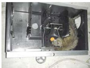
Rotte i felle i kjelleren
