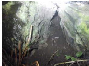
Spør etter rotter i steinmur på baksiden av boligen.
