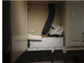
Over kjøkken vifte er det gnaget.
