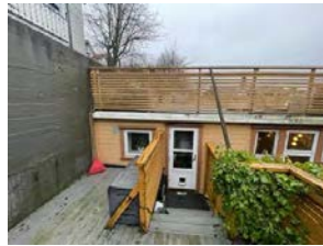
Oversikt. Det må sikres til høyre for terrassedør, og under plattform til venstre.
