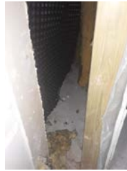
inne i vegg hvor rotte har blitt funnet død
