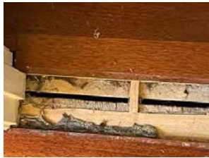
Glippe under terskel, dør til soverom.
