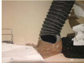
Rotten har gnaget seg igjennom vifterør.
