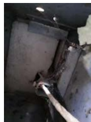
inn under strømskap på utsiden
