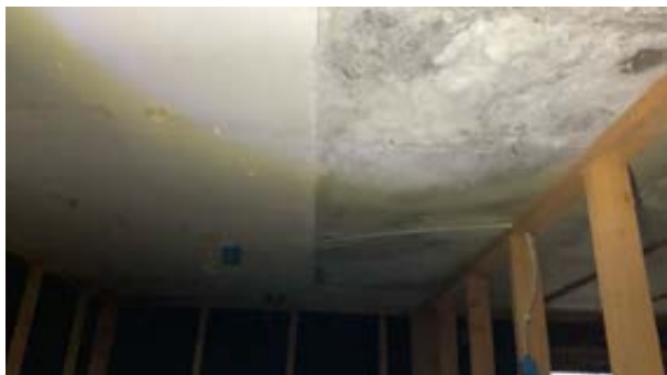
Saltutslag under betong plate.
