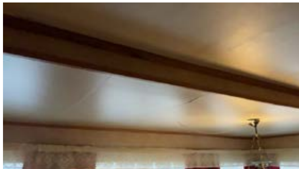
Skade på himling under altan
