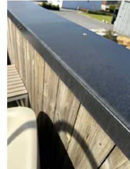
Liten/ingen utlufting under toppbeslag
